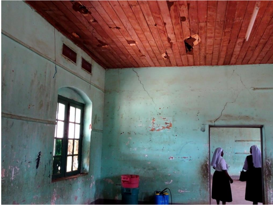
Fotos 8. Estado de techos, paredes y ventanas
