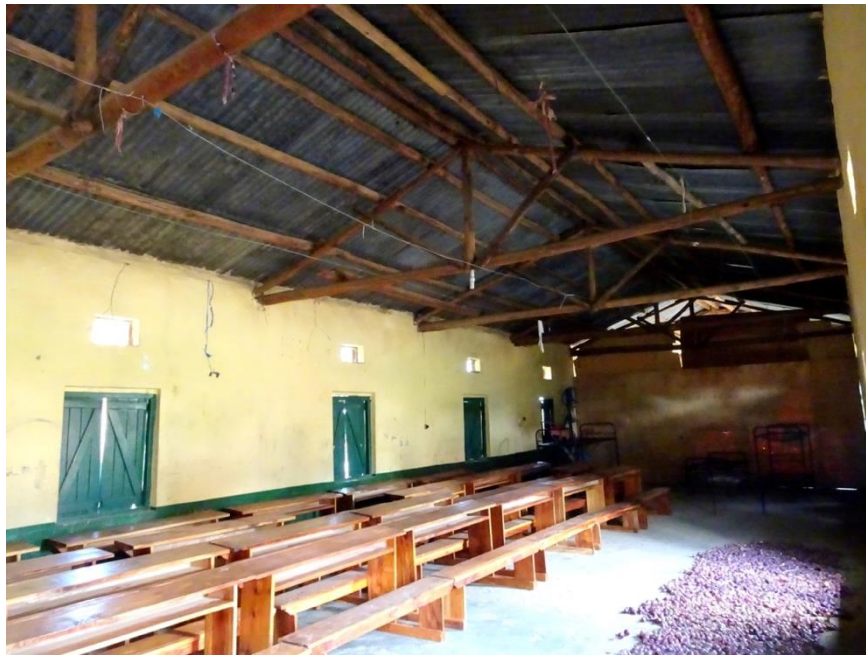
Fotos 5. Estado del tejado interior
