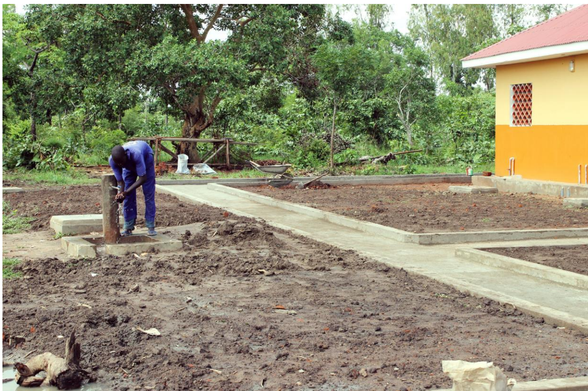
30 Punto de acceso de agua.
