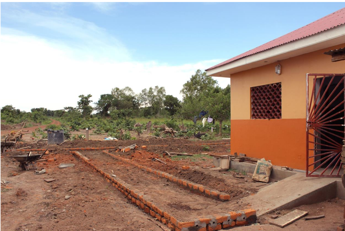
17 Mejoras del exterior, pasillo que conecta todas las aulas con los baños para niños en silla de rueda
