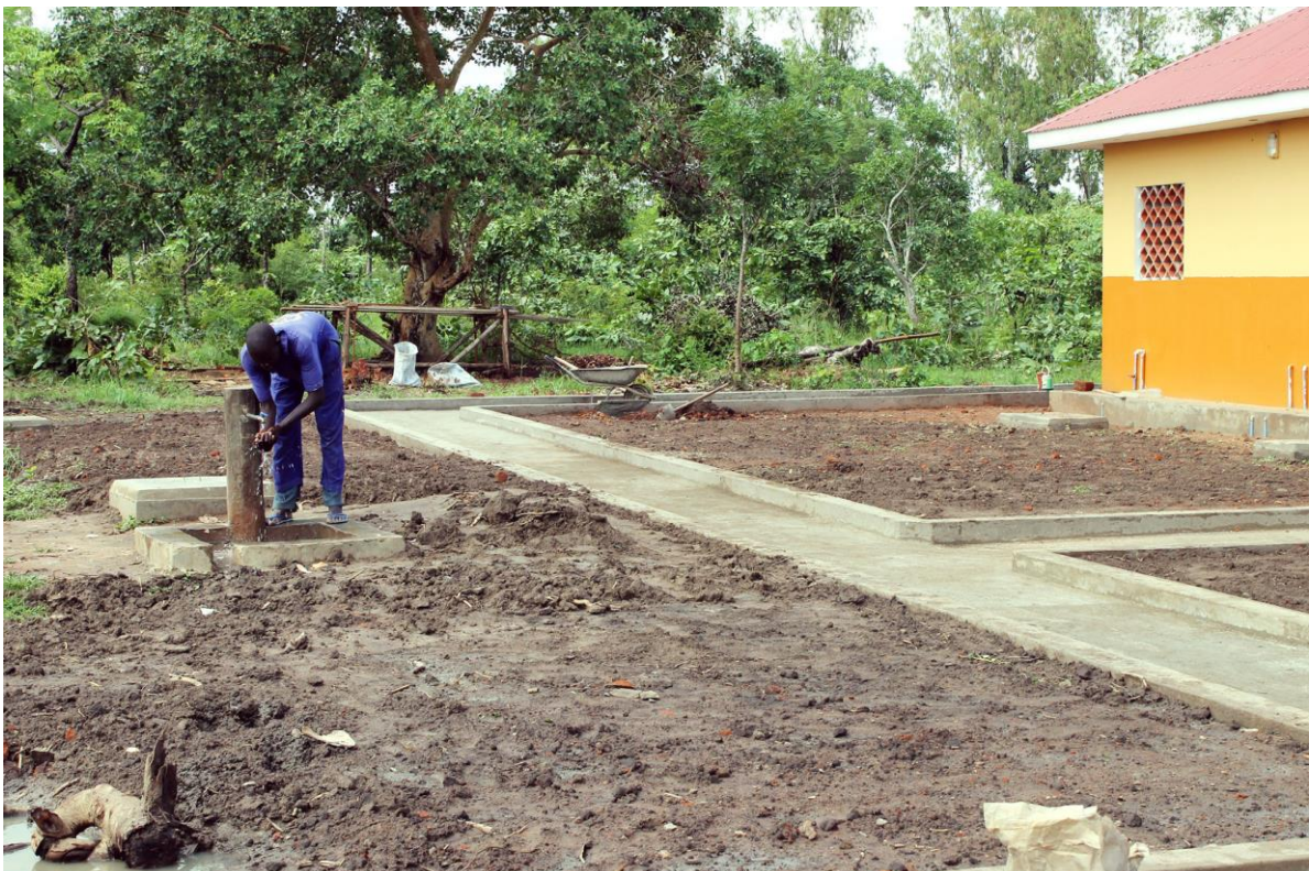
30 Punto de acceso de agua.
