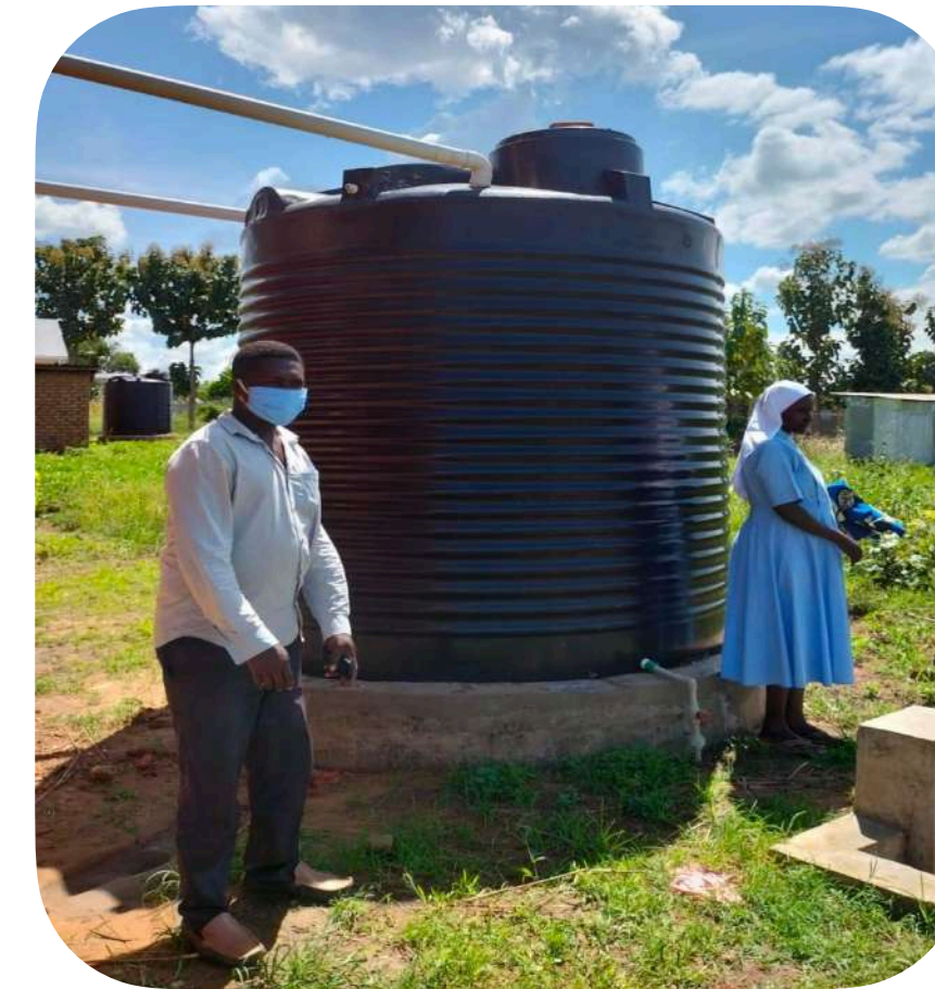
Construcción del sistema de recogida de agua en la Escuela Primaria Divine Mercy (Nebbi, Uganda).
