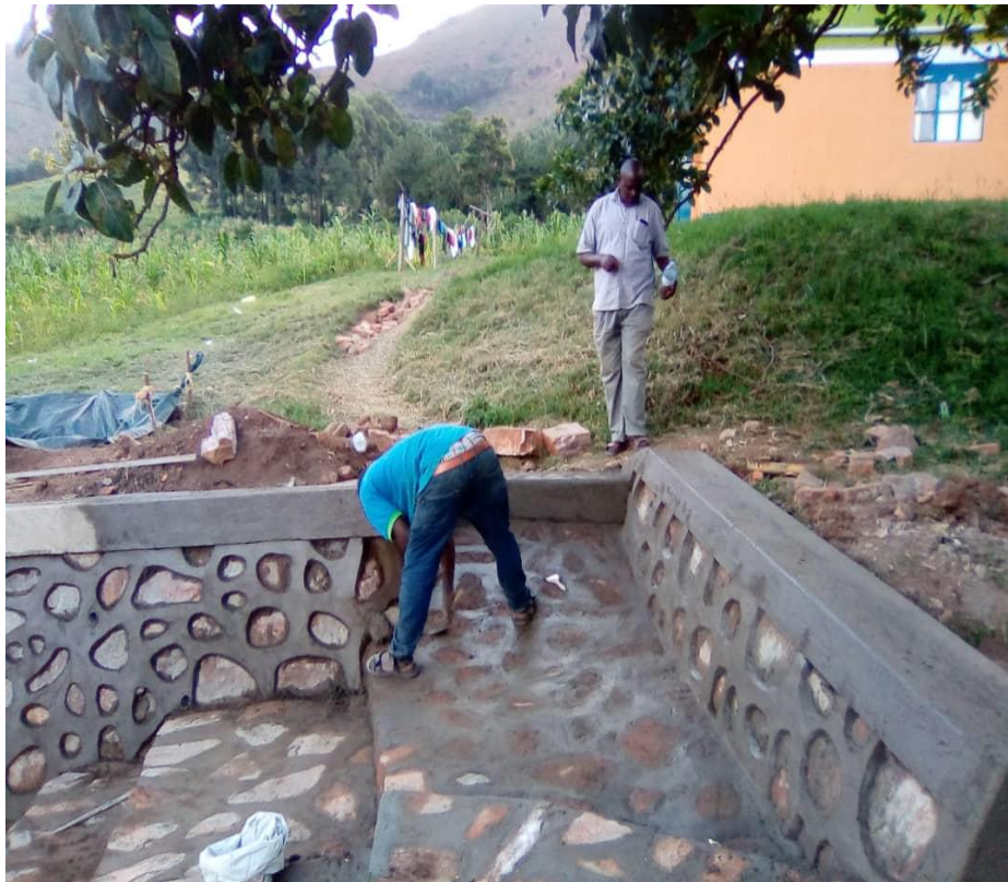
Imagen 08. Foto de uno de los ingenieros revisando el muro.
