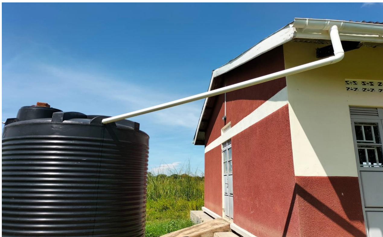
2. Uno de los tanques de agua (10.000 litros) junto con el sistema de canalización.
