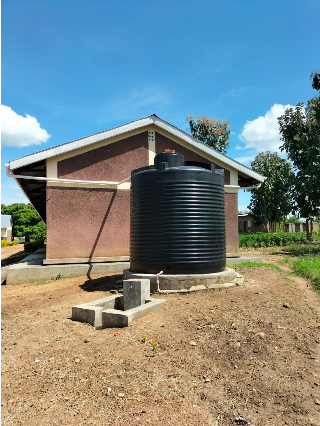
4. Tanque de agua, sistema de calinización y su respectiva fuente
