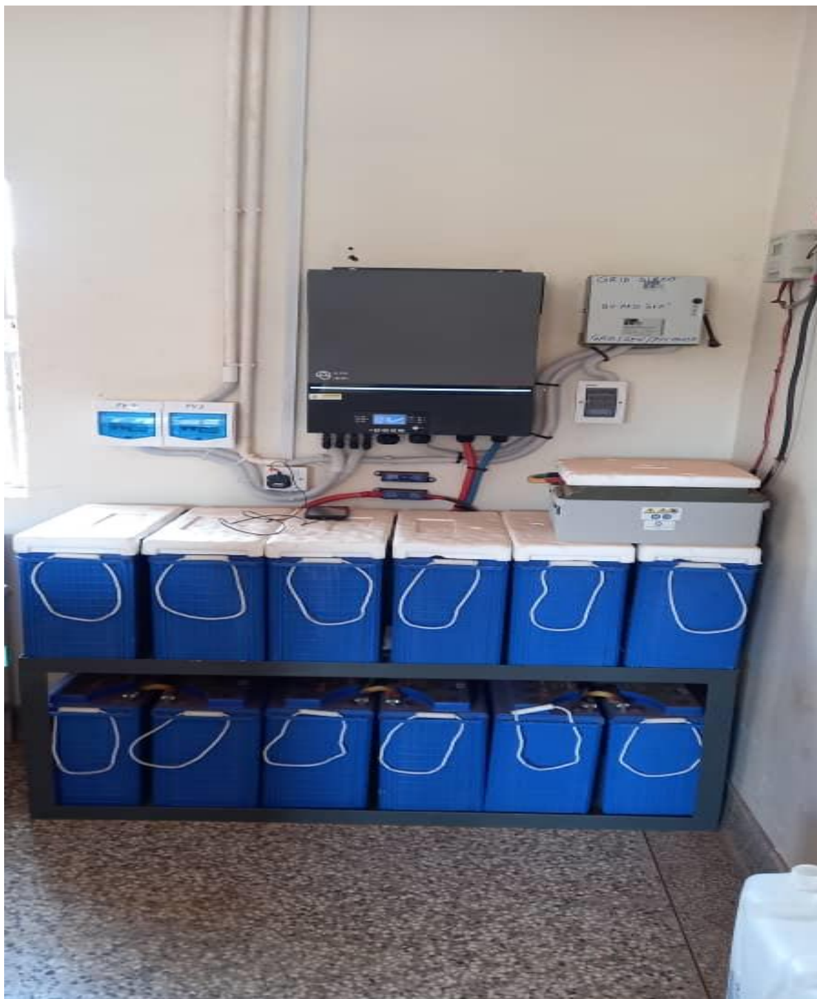
2. Muestra de baterías y transformadores del Centro de Salud de Yumbe
