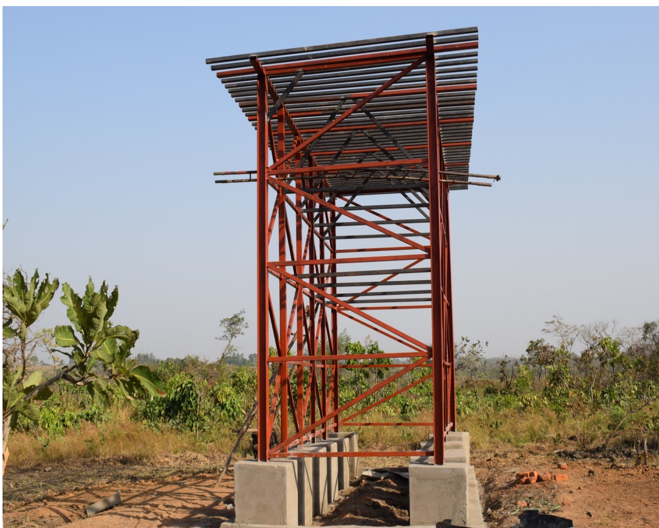
3. Estructura de elevación de 5 metros de los tanques
