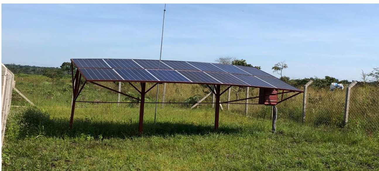
5. Paneles solares que proporcionan la energía necesaria a las bombas.
