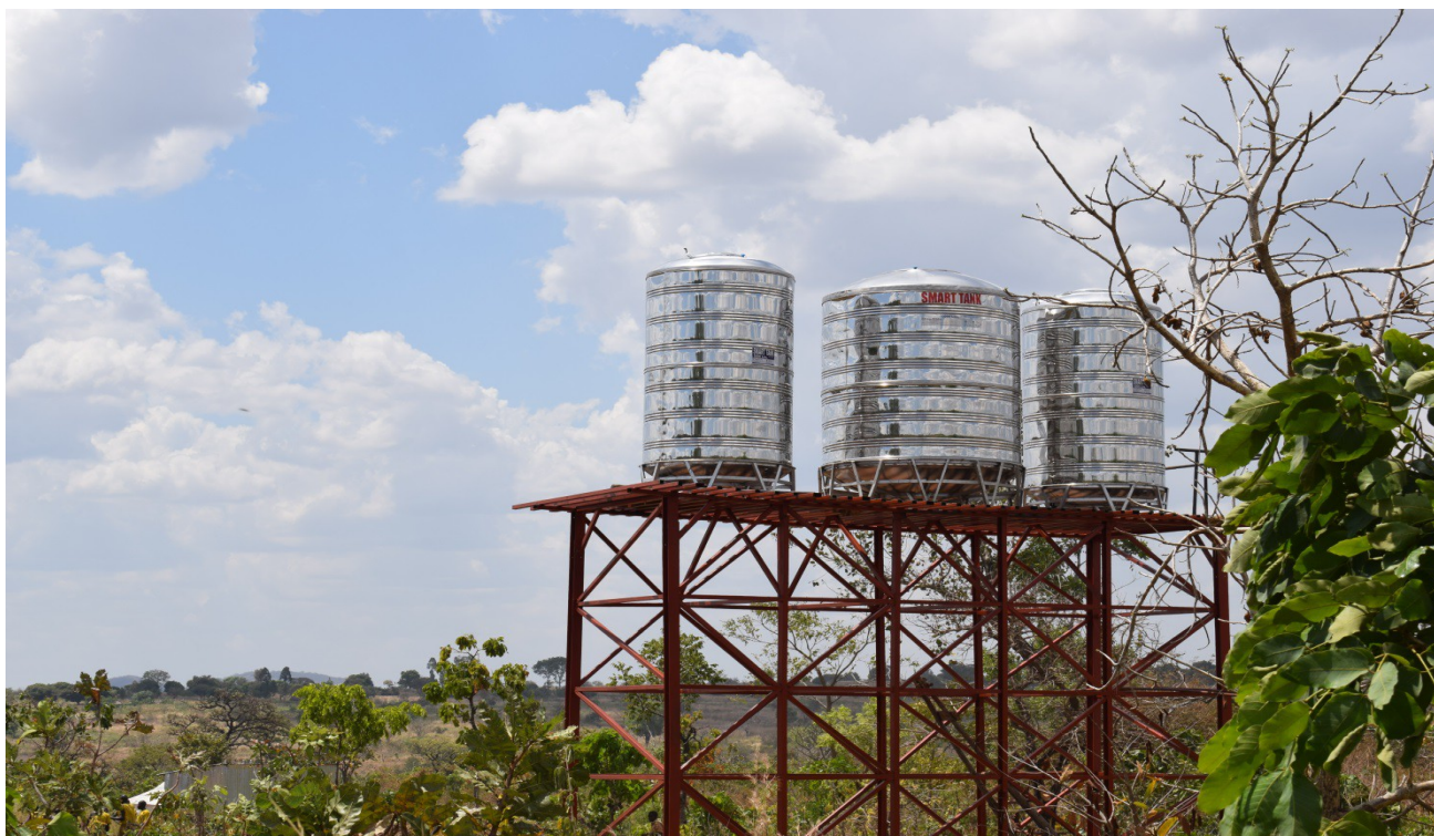
8. Foto de los tres tanques elevados que aportan el agua al colegio.
