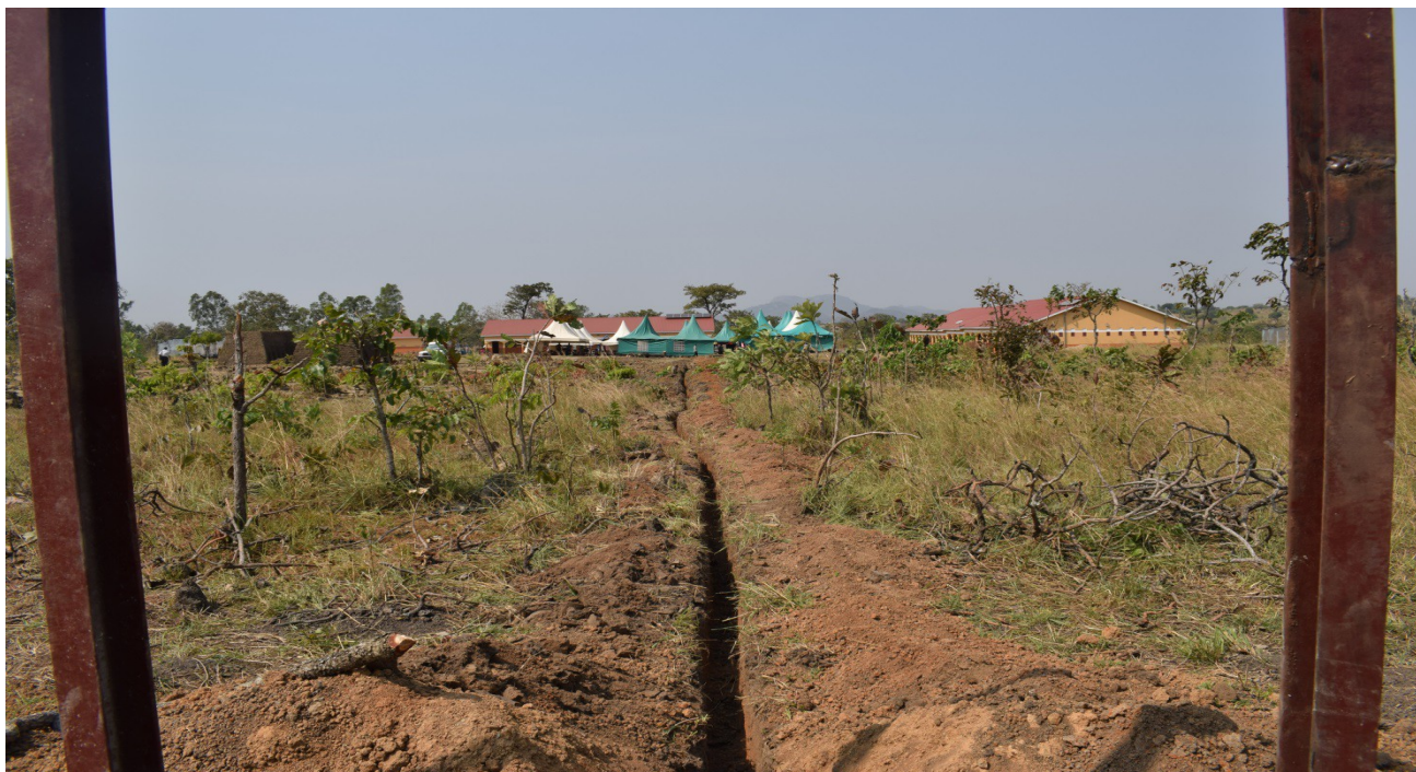
4. Distancia que recorren las tuberías de agua desde los depósitos hasta el colegio.
