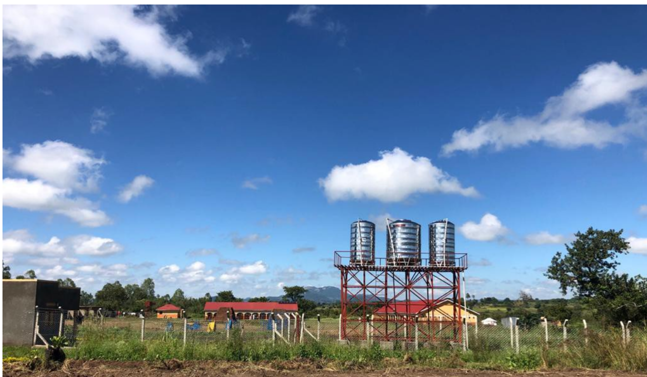
9. Foto general desde fuera del colegio que muestra los depósitos y demás instalaciones.
